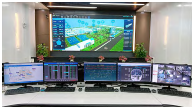
沙口水厂中央控制室全貌
